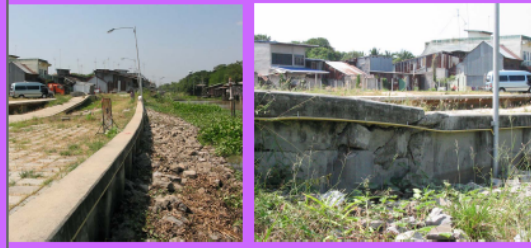
รูปแสดงการเอียงของเสาไฟและความเสียหายของ CAB BEAM คลองทวายสายล่าง จ.ฉะเชิงเทรา
